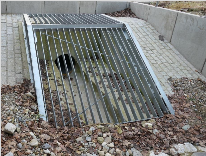
Einlaufbauwerke mit 3D-Rechen
